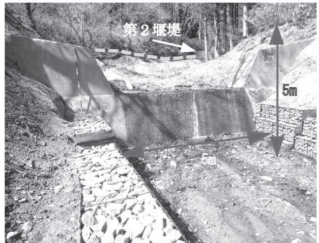
図6. 地点3, 琴木沢第1堰堤付近の土石流跡 (2022.4.9撮影).
