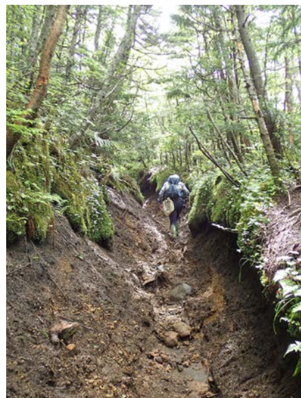
図2-8 洗堀によって抉られた登山道 （黒斑山中コース上部）
